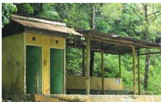
Gambar 9. Gazebo dan toilet yang rusak
